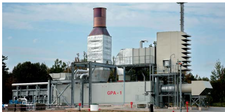
Новый газоперекачивающий агрегат
